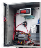
Control de seguridad de temperatura
